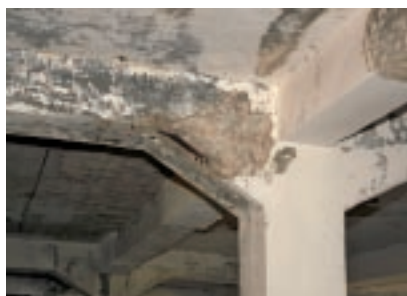
So stellten sich die Schäden in der Tiefgarage dar.
