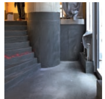
Auch die Treppen im Aufgang wurden „gekempert“, um die Randfugen zwischen keramischem Belag und tragendem Mauerwerk abzudichten.
