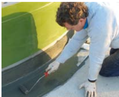
Trotz WU Beton kann besonders im Fugenbereich der Fundamentsockel auf eine langzeitsichere Abdichtung nicht verzichtet werden.
