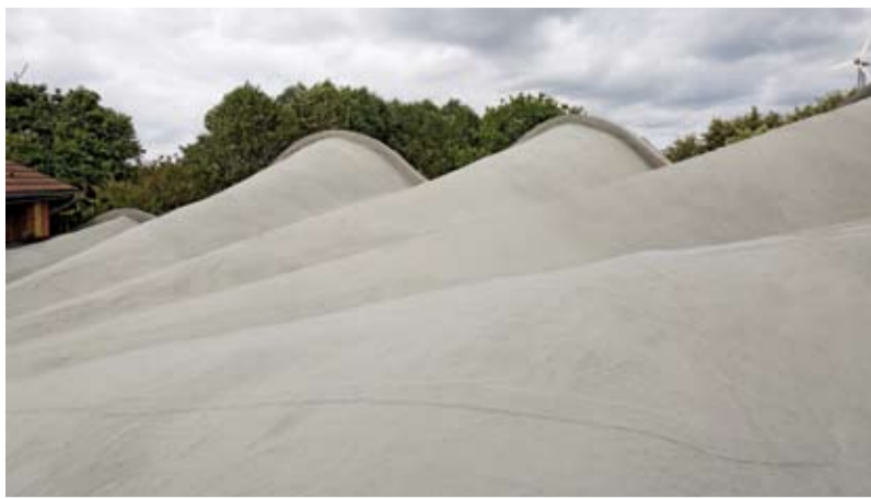
Die Nubischen Gewölbe wurden mit KEMPEROL® abgedichtet, weil der Lehm aus dem Lehm ohne Abdichtung nicht wasserundurchlässig ist.
